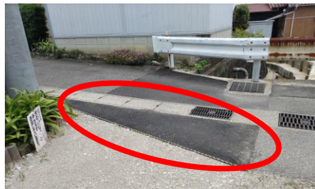
八幡町三丁目3番地(吉浜住宅付近)の側溝脇の陥没による、自転車の転倒や車両のタイヤ切れの恐れを、アスファルトにて修復
